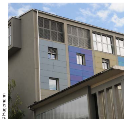
Abb. 5.7-03: Ehemaliges Kohlesilo, Basel, mit PV-Wandverkleidung
