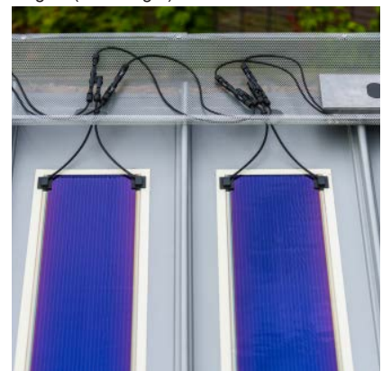
Abb. 4.5.3-02: Verkabelung OPV-Module auf einem Dach
