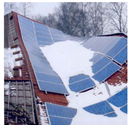
Abb. 9-12: Schaden durch Schneedruck
