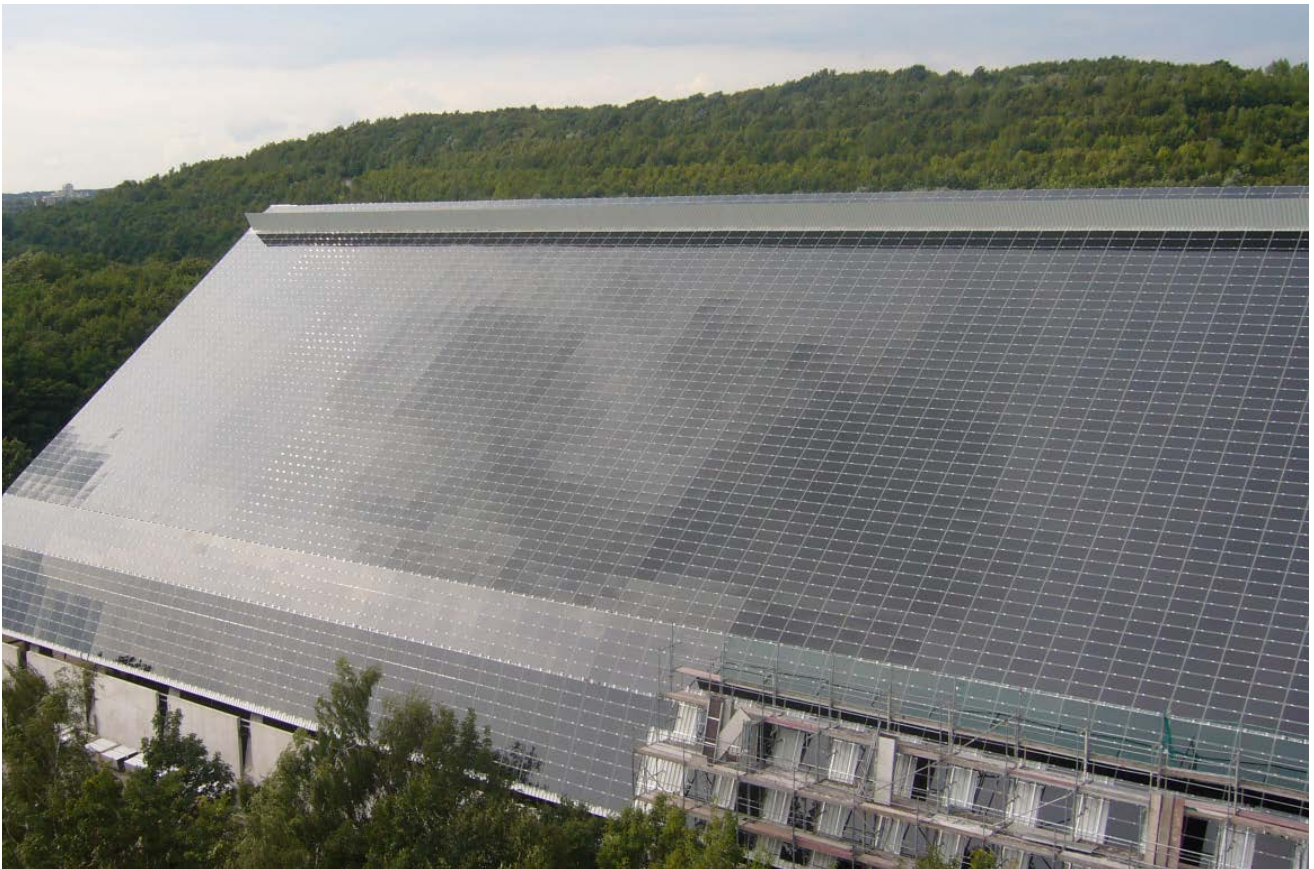
Abb. 7.1.2.1-06: Aufdachanlage mit CdTe-Modulen, Riedel Recycling GmbH, 837 kWp
