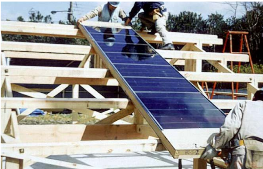
Abb. 7.1.2.3-01: Komplett PV-Dachsystemlösungen mit integrierter a-Si-Modulen von Kaneka, Japan
