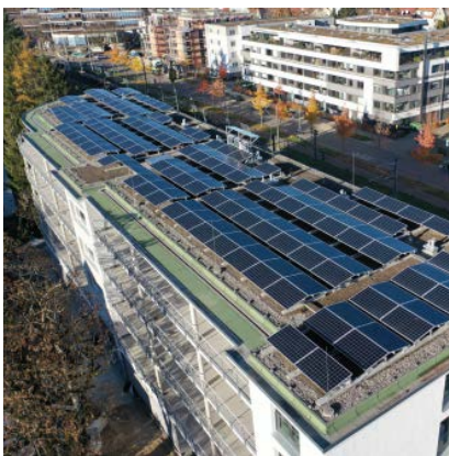
Abb. 7.4-03: PV-Dachanlage mit kristallinen PV-Modulen, Gesamtleistung: 70 kWp
