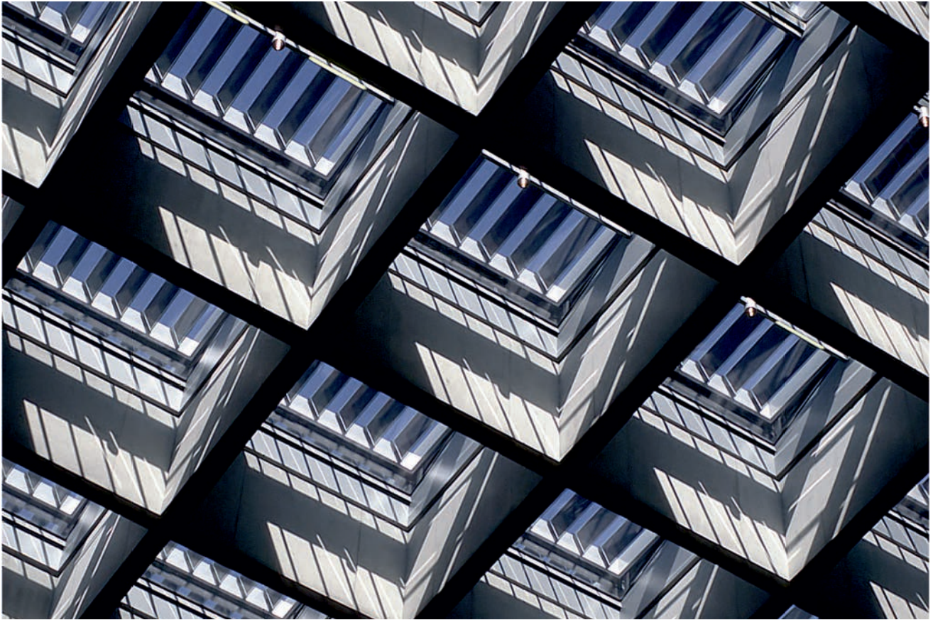
Abb. 6.2-08: Lichtsteuerung mit beweglichen PV-Lamellen aus Dünnschichtsolarzellen auf dem Dach des Paul-Löbe Hauses, Berlin
