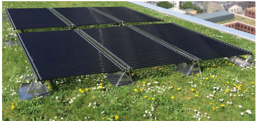
Abb. 7.2.2-05: Gründachaufständerung von Röhrenmodulen, Tube Solar AG
