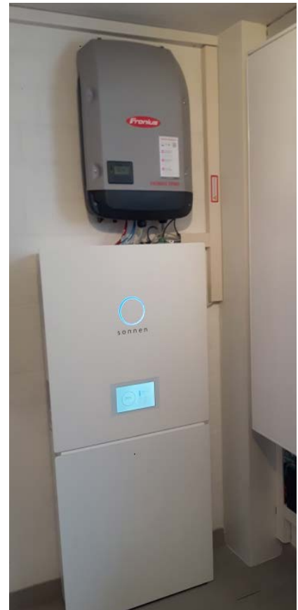
Abb. 4.5.3-03: Batteriespeicher der Firma Sonnen für ein Einfamilienhaus (vgl. weiße Box unten), Wechselrichter der Firma Fronius (vgl. graue Box oben)
