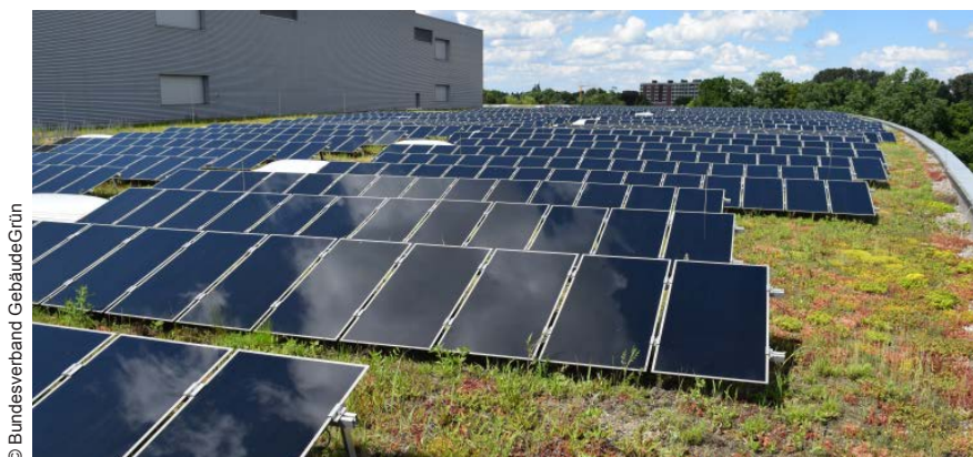
Abb. 7.2.2-02: PV-Gründachanlage mit rahmenlosen CdTe-Modulen, Möbelhaus Höffner, Hamburg-Eidelstedt, 672 kWp
